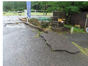
はがれたアスファルト
